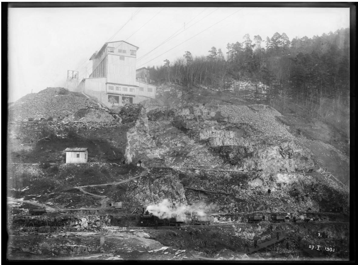
Jaroslav Bruner-Dvořák: Stavba Vranovské přehrady, 1931 Skleněný negativ 18 x 24 cm. Archiv NTM, f. 800 – nezpracovaná část, kr. 56
