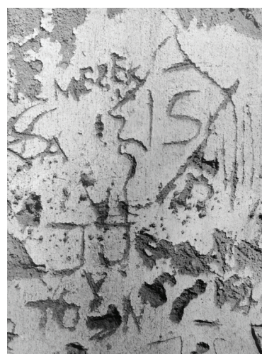
Rozrušená stěna se znaky, 1962
