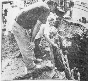
Dělníci sledují svého kolegu při práci ve výkopu na křížovce Anděl. FOTO: MAFA - ALŽBĚTA JUNGROVÁ
