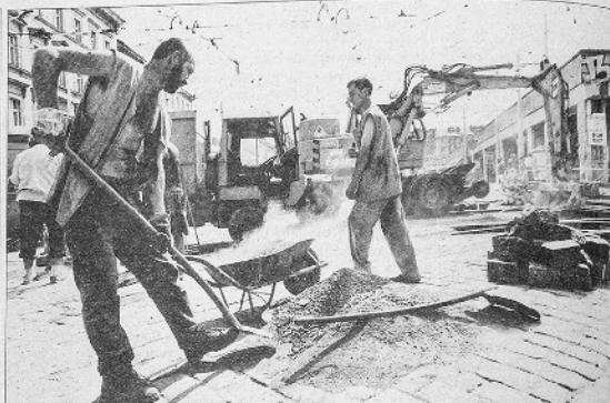
Dělníci v blízkosti koleji musí dělníci rozložit ručně (nahore), zatímco s asfaltem si poradí bagr (dole). FOTO: MAFA - ALŽBĚTA JUNGROVÁ
