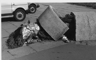
1. Rurociąg wyrywa się z ziemi w punkcie A
