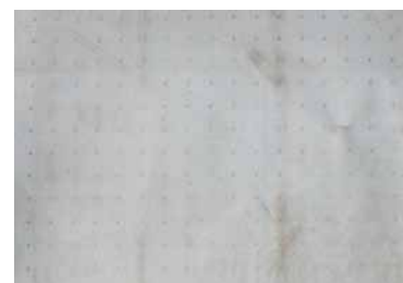
Následky poškození nebylo ani konzervací možné odstranit.
