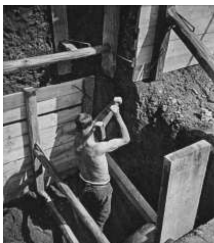
Přemysl Koblic: Kopání základů (ve Fotografickém obzoru uveden název Vyztužování ) Fotografický obzor 1938
